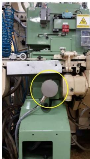
Figura 27 – Ejemplo del Encoder instalado
